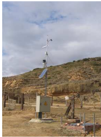
Imagen 1 Detalle estación de clima y sistema de control del prototipo
