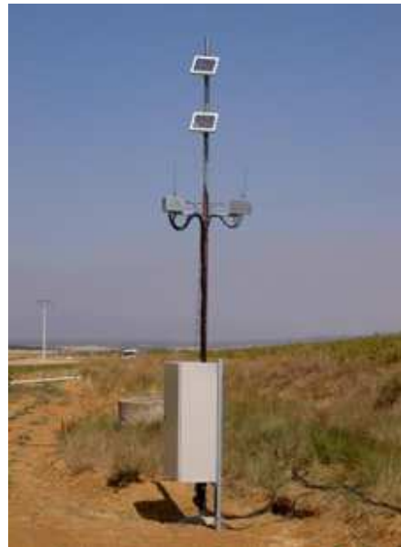
Fig. 12. Instalación de las 2 estaciones remotas en un poste
