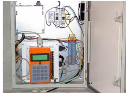
Fig. 9. Detalle del interior de la Estación Concentradora
