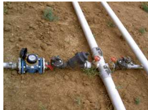
Fig. 11. Contador de agua, llave de paso y electroválvula.
