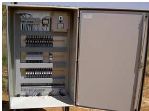
Fig. 10. Armario donde se instalan los terrruptores y las conexiones.
