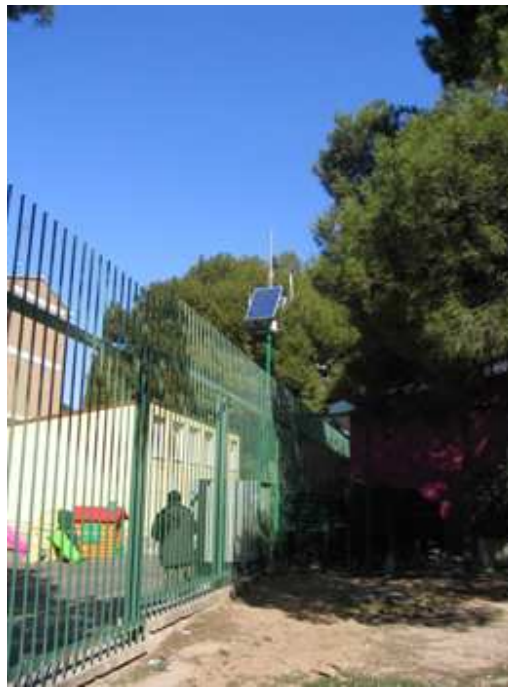
Fig.8. Sistema instalado dentro del recinto del colegio público
