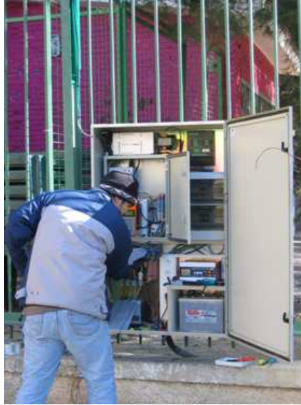
Fig. 13. Sistema dentro de la caja central de control
