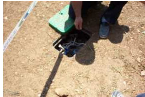
Fig. 10. Arquete donde se ubica la electroválvula de la red EV2
