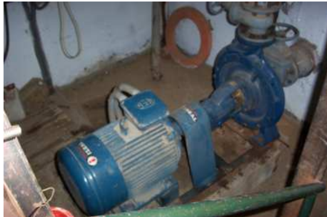
Fig. 9. Bomba de agua
