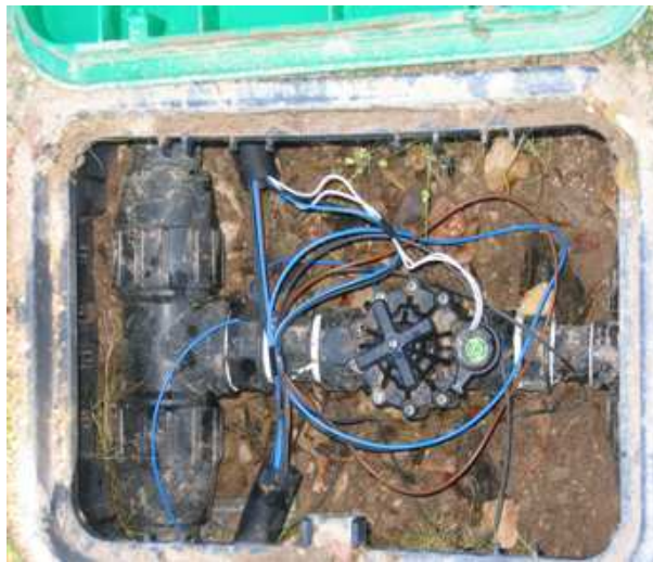
Fig. 11. Detalle de una electroválvula de la zona de control
