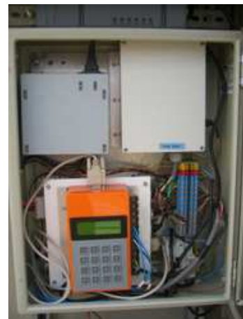
Fig. 10. Detalle del sistema donde se aprecia el teclado y conectado.
