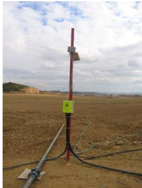
Fig. 14. Remota radio instalada en el poste
