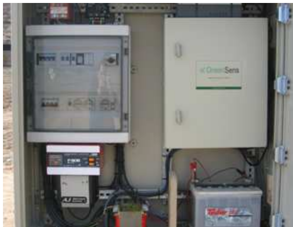
Fig. 9. Caja central donde está ubicada la concentradora.
