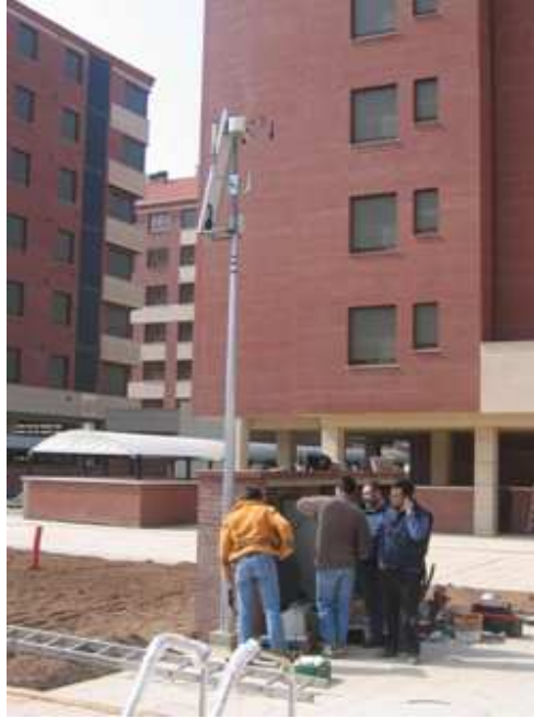
Fig. 10. Vista de la estación climática y del armario central (donde están puestos la concentradora, los contadores y las electroválvulas)
