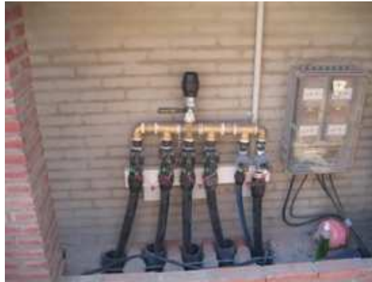
Fig. 13. Electroválvulas en el interior del armario central
