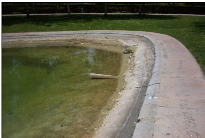
Imagen 15: Vista de la entrada de agua que proviene del pozo
